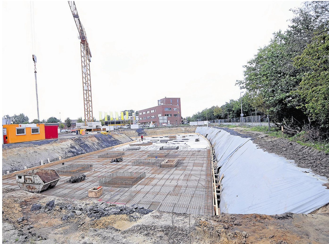
Im Keller des Erweiterungsbaus entsteht eine Tiefgarage. Die Parkplatz-Situation am Einkaufszentrum soll sich in Zukunft deutlich verbessern. MZ-Foto Eltzorn
